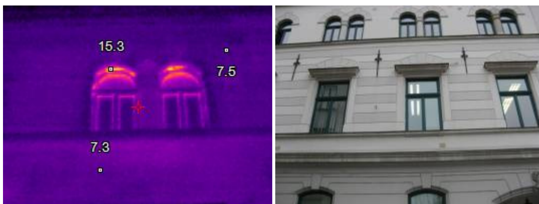
Slika 22: Izgube toplotne energije (občina Idrija)
